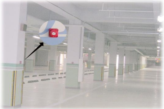
무선비상스위치가 부착된 주차장
